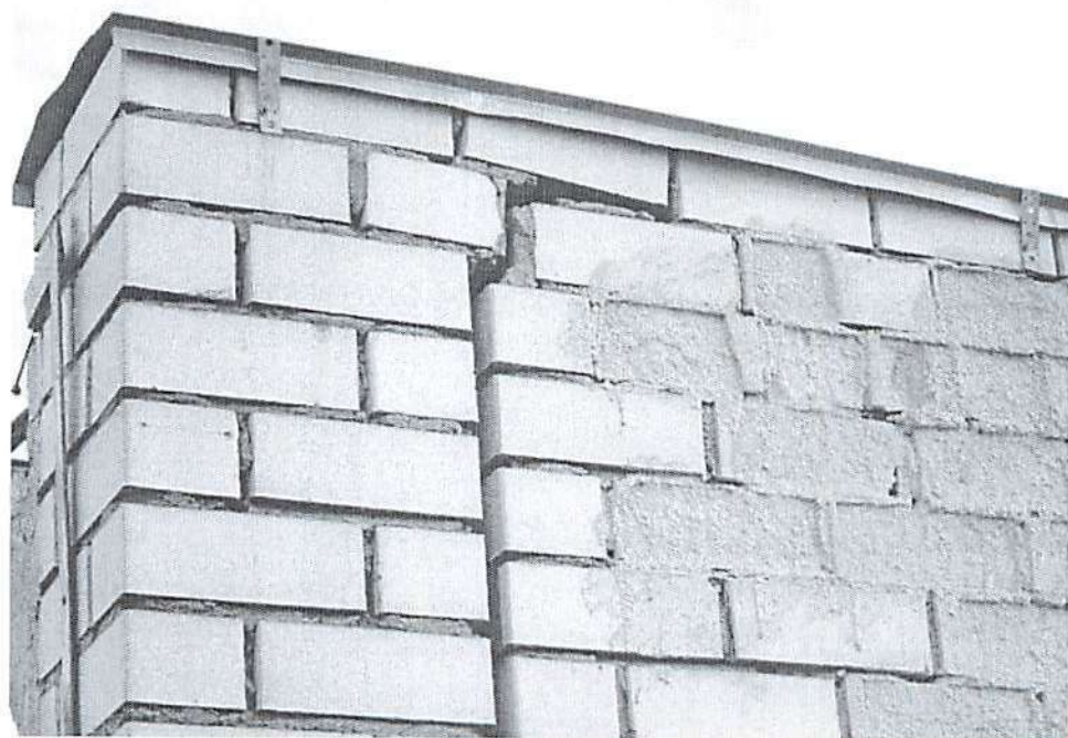
Фото 3.6. Отсутствие перевязки в кирпичной кладке лестницы.
