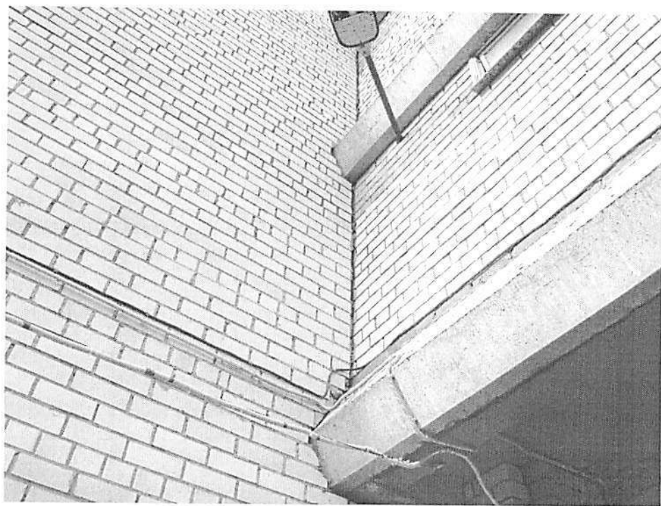
Фото 3.4. Зазоры между кирпичной кладкой основного здания и пристроенной лестницы.
