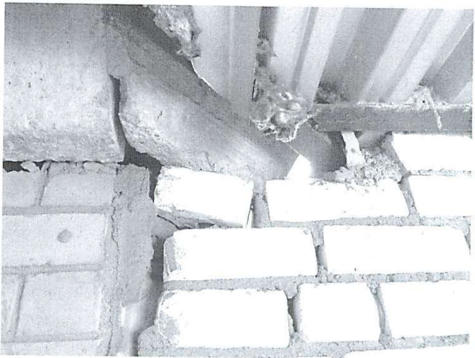
Фото 3.8. Состояние кладки пристроенной лестницы в уровне верхнего (восьмого) этажа.
