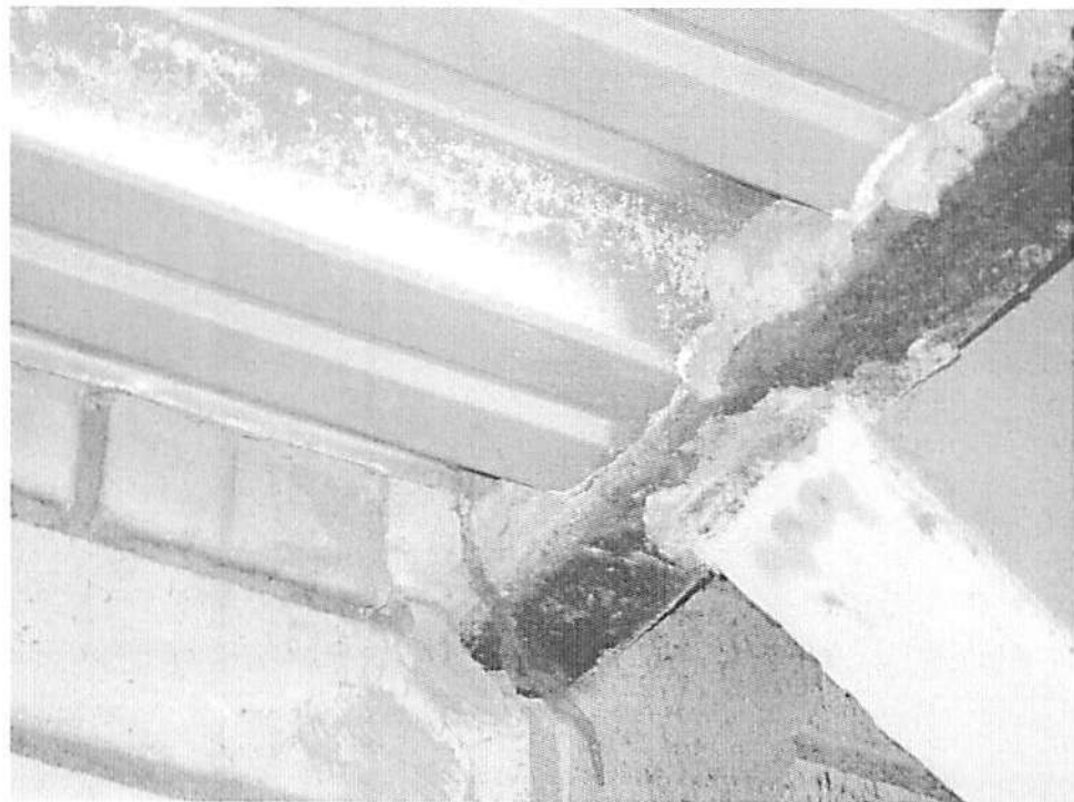
Фото 1.4. Состояние несущих конструкций лестниц.
