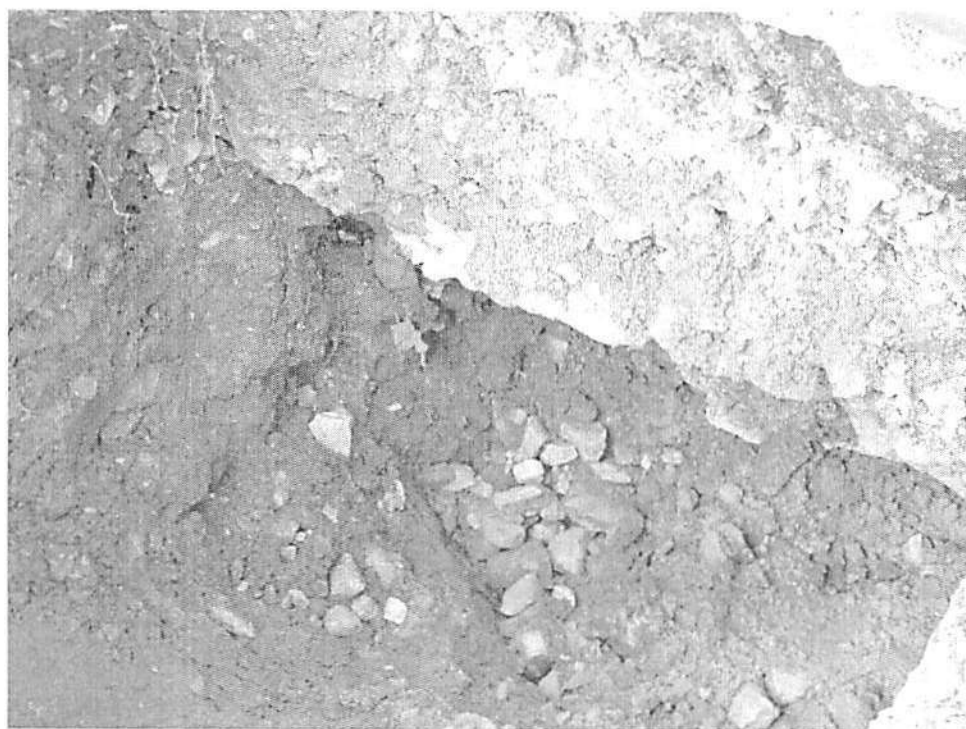
Фото 2.2. Общий вид и состояние фундамента лестницы № 1.
