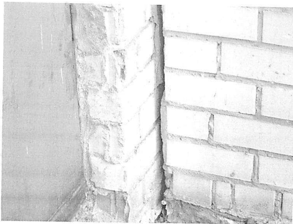
Фото 3.3. Отсутствие перевязки кирпичной кладки основного здания и пристроенной лестницы.
